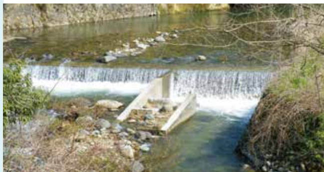
① 過去に設置された魚道が破損
