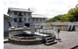
漁業集落排水施設
