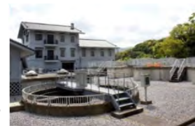
漁業集落排水施設
