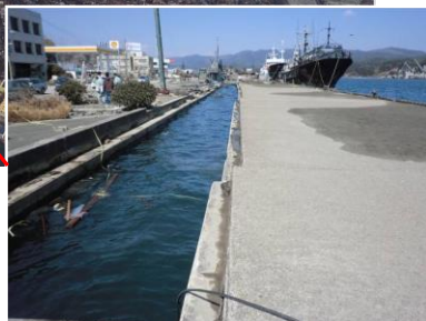
倒壊した岸壁
