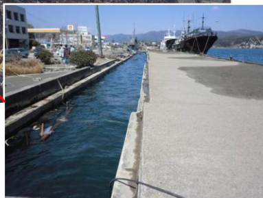
倒壊した岸壁
