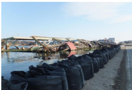
荷さばき所の被害状況
