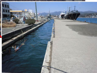
倒壊した岸壁
