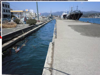
倒壊した岸壁
