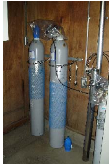
エチレンボンベ (JA 土幌町実験庫)
