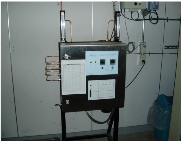
エチレングス制御装置の内部 (JA 帯広かわにし：平成 21 年 5 月 14 日現在)
