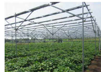
露地の畑の上部にパネルを設置
