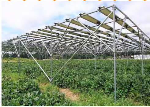
発電設備の外観
