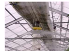
細霧冷房装置
