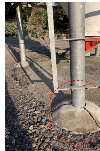
写真⑥ 根巻きコンクリートのひび割れ ※ぐらつきやガタつきがある場合は報告をお願いします。
