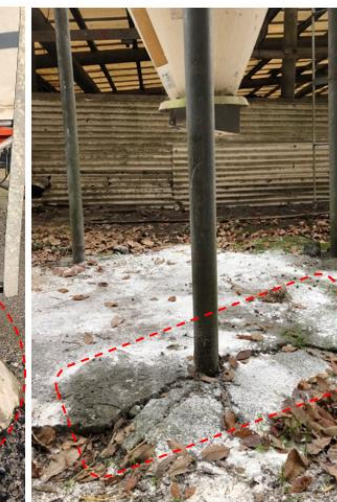
写真⑮ 基礎のひび割れ状態 ※ぐらつきやガタつきがある場合は報告をお願いします。
