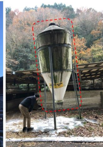
写真② 本体の傾き ※倒壊の恐れがあるため至急交換が必要。
