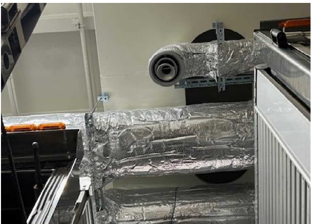
図14 車両甲板内ダクト
