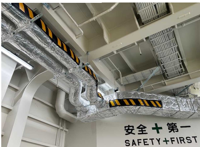
図12 車両甲板内ダクト
