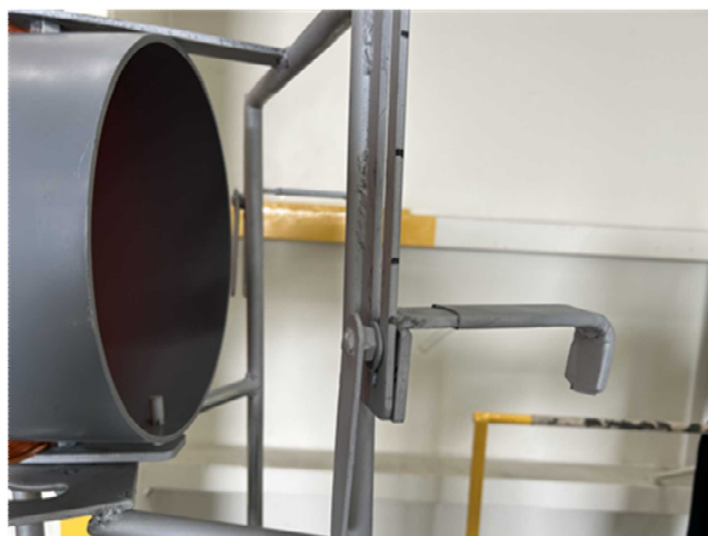
図26 ダクトひっかけ部分
