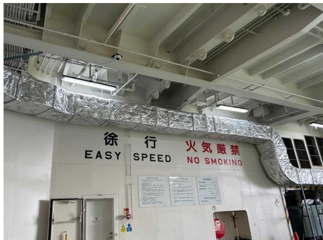
図11 車両甲板内ダクト
