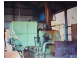
【直接焼却施設】
