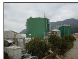
【メタン発酵施設】
