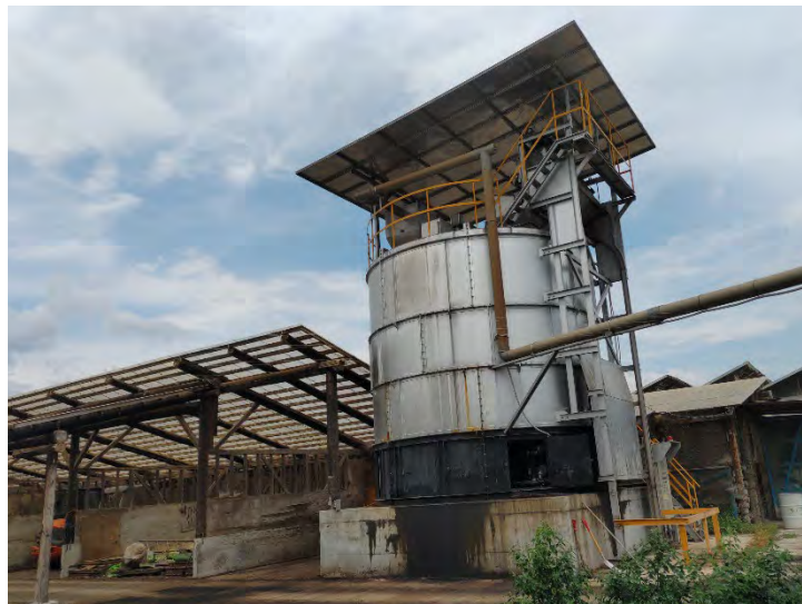
密閉縦型堆肥化装置(縦型コンポ) 外観
