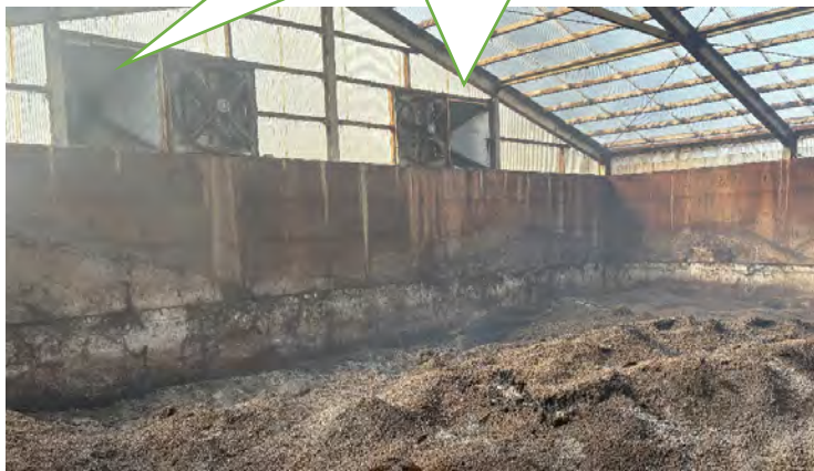
直線型堆肥化装置が設置された 閉鎖型堆肥舎
