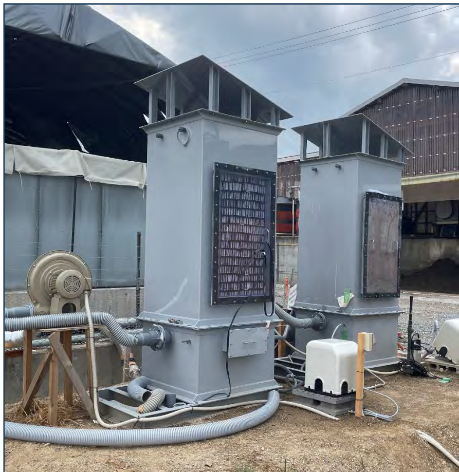
スクラバー脱臭装置外観 (2台)
