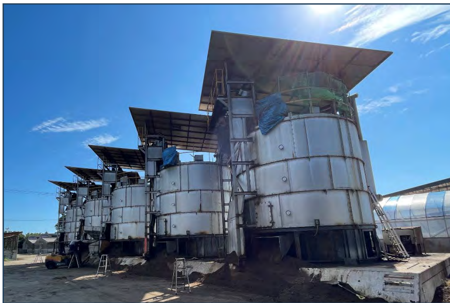
(1) 密閉縦型堆肥化装置
