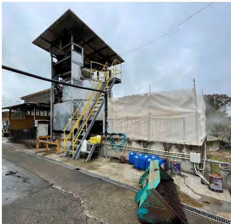
密閉縦型堆肥化装置(縦型コンポ) 付属の水洗脱臭装置
