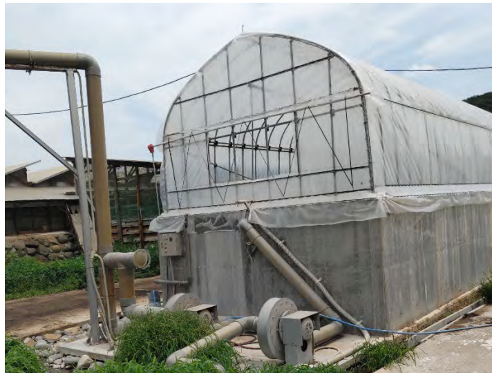
軽石＋水洗脱臭 装置の外観 (ビニールハウ スで覆っている)
