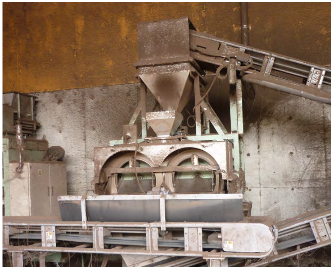
ツインダイス式ペレット化装置（現地設置）
