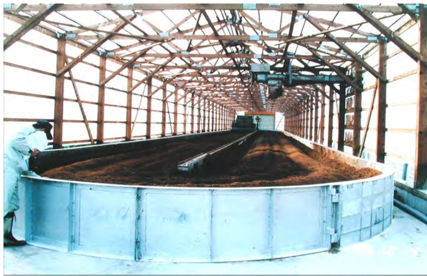
回行型発酵槽による堆肥化装置
