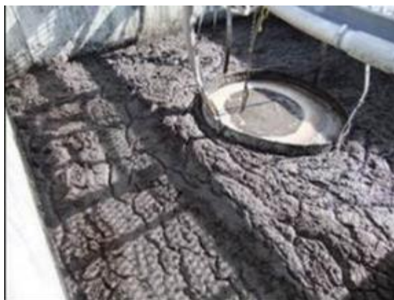
図 15. 沈殿槽の汚泥蓄積トラブルの事例
