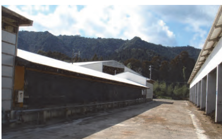
ロータリー式攪拌堆肥舎外観（左側）
