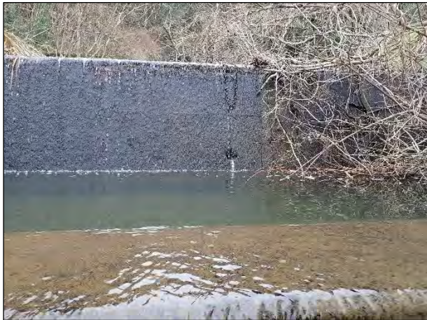
止水堤の水抜きにある栓を抜くためのチェーン。
