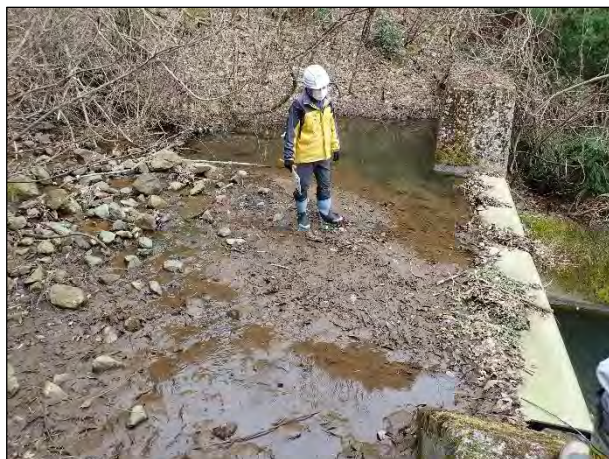
鋼製スクリーンダム堆砂敷上の細粒土(濁質)。
