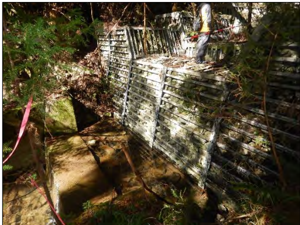
鋼製柵を浸透して湧出した渓流水
