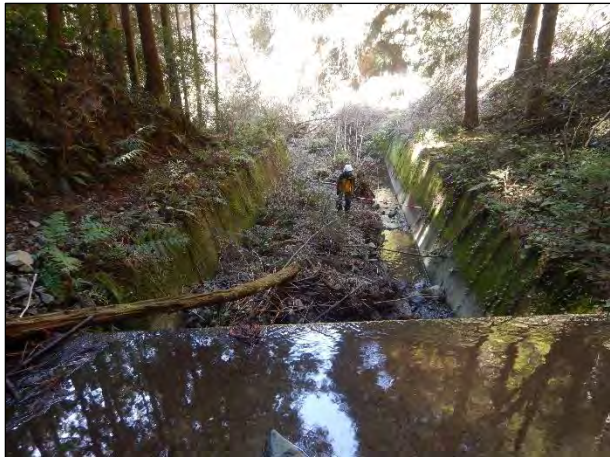
流路工のトンカゴは破壊され右岸脚部を侵食
