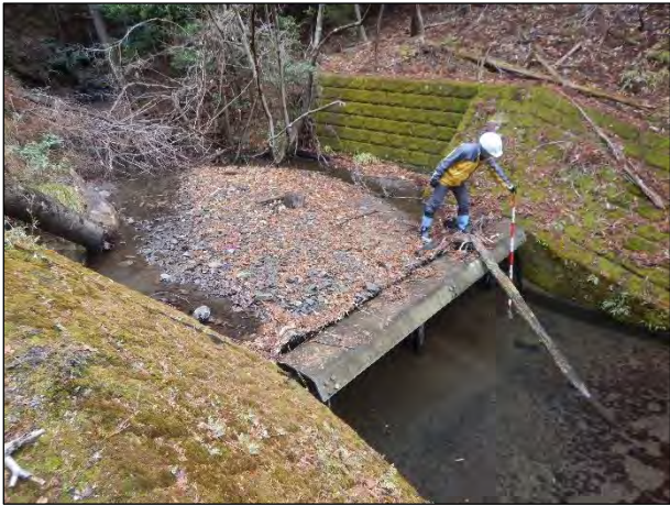
鋼製スクリーンダムの水叩部と堆砂状況。
