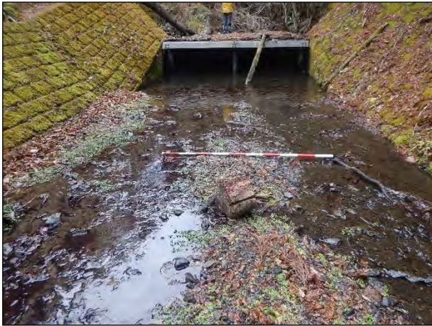
鋼製枠の表面を渓流水が流下している。
