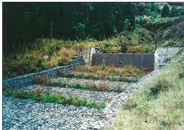
施工後2年経過した施設の表面 木炭フィルター部に植生が侵入
