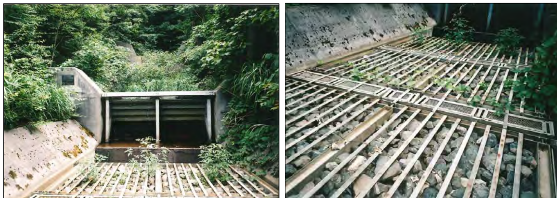
図 4.7 渇水期の鋼製枠と木炭カードリッジ
