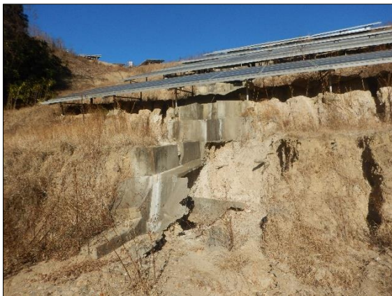
写真 5.1 盛土面の侵食とコンクリート水路施工
