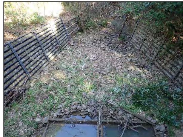
治山ダム上流から下流方向 木製沈床の洗堀。
