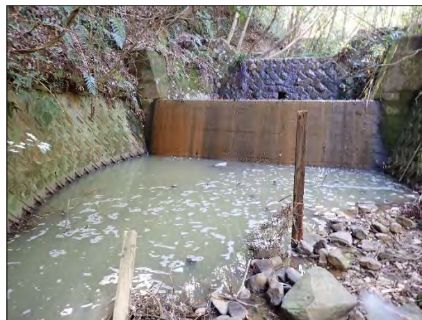
水質保全施設直下の治山ダム。濁水が発生。
