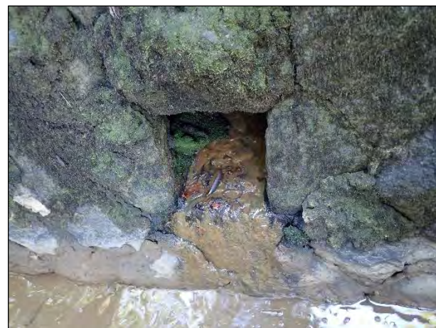
治山ダム水抜きからの湧水。濁質を含む。
