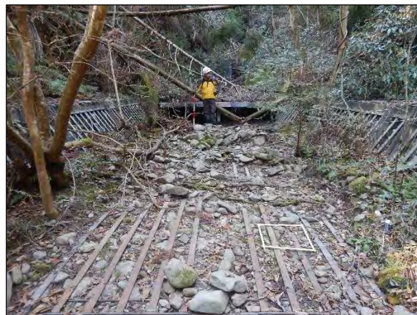
水質保全施設の流路
