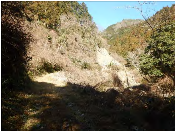
作業道は崩落により車両の通行は不能
