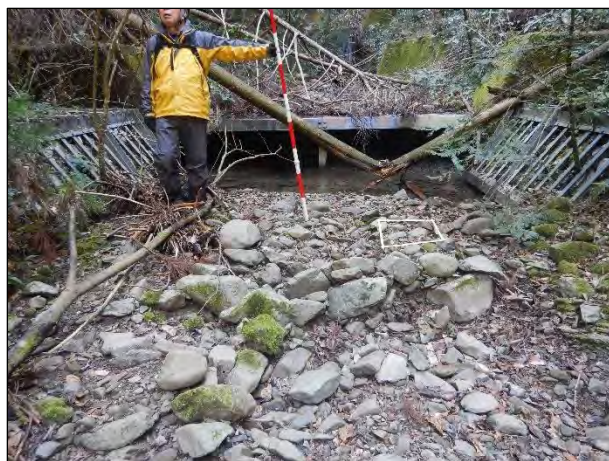
鋼製スクリーンダム直下の土砂堆積(表流水なし)
