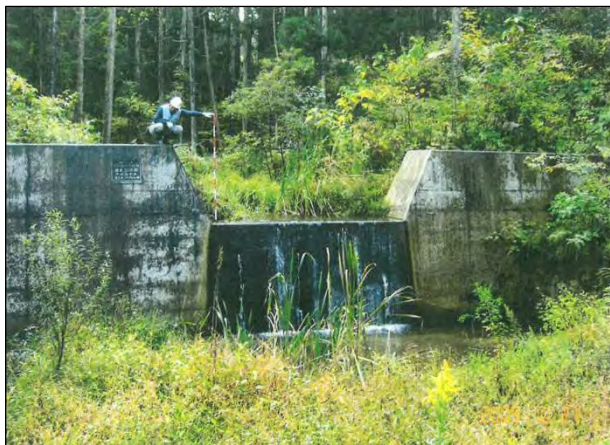
小径水抜群から堆砂敷の透過水が流出
