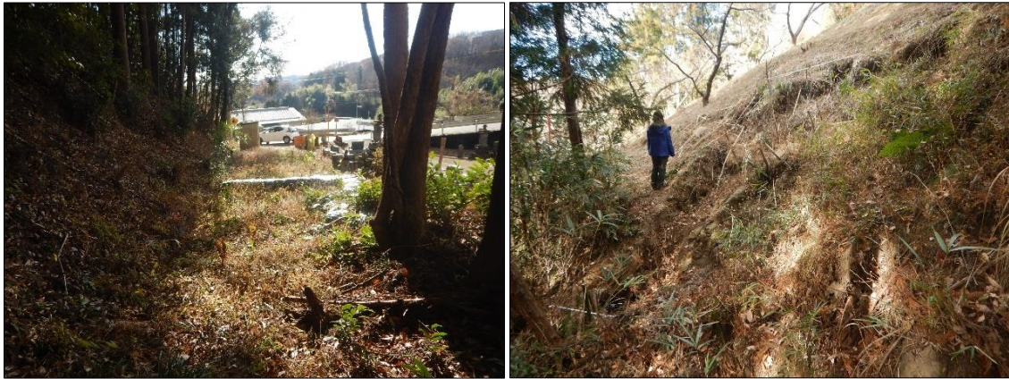
写真 5.12 事例(3)詳細:墓地に配置された土嚢と土砂崩壊発生源
