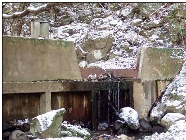
流量観測施設
