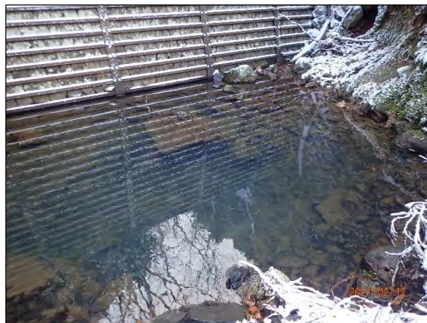
堤体前面からの湧水。
