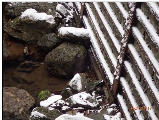
堤体前面からの湧水を確認。
