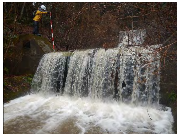
スクリーンダムの水叩 濁水で鋼製杵は見えない
