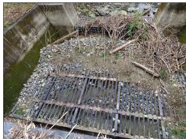
水叩部は間詰石が移動・流出。
