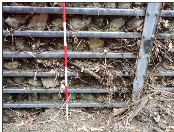
治山ダム透過部の目詰まり状況。
