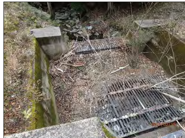
水叩部は間詰石が移動・流出。
