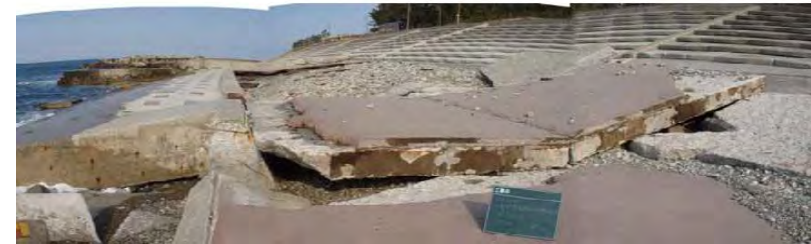
波によるブロック散乱→護岸崩壊
