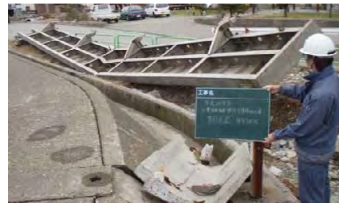
波力によるゲート破損
