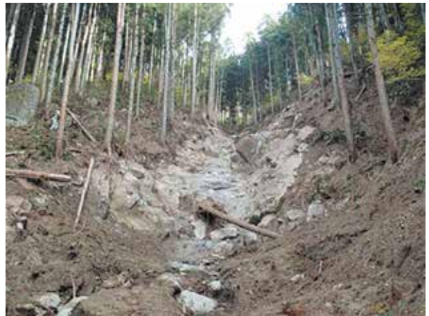
崩壊源頭部付近
