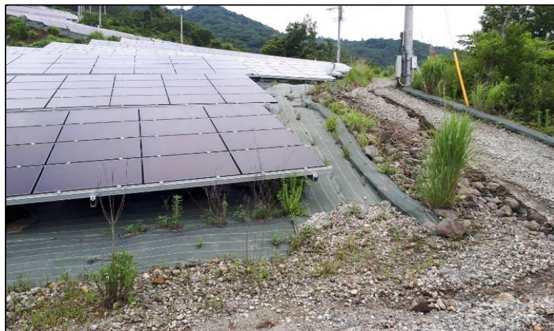
写真 2.3 太陽光発電施設の状況
