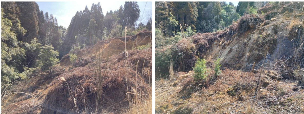
写真 3.2 崩壊地①の状況
