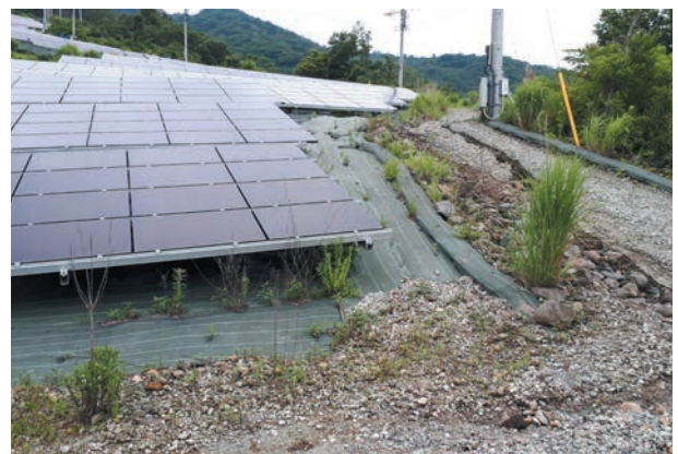
太陽光発電施設の状況
