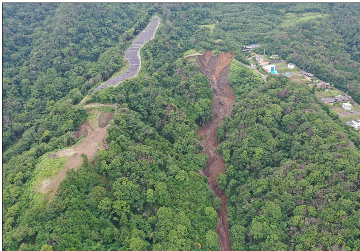
写真 2.1 崩壊源頭部全景
