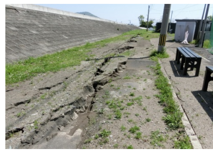
堤体の液状化
