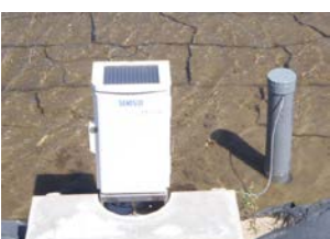
自動給水栓の導入
