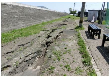
堤体の液状化
