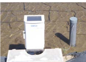
自動給水栓の導入
