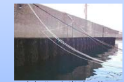
老朽化した岸壁の状況
