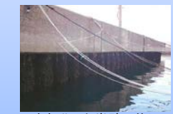
老朽化した岸壁の状況
