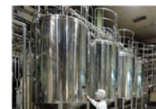
生クリーム貯蔵施設
