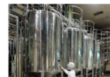
生クリーム貯蔵施設
