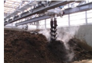
畜産環境対策施設
