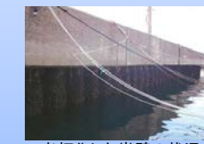
老朽化した岸壁の状況
